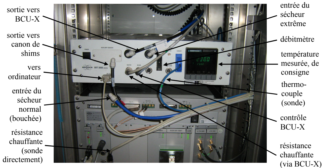
Figure 6 : unité de contrôle de température (BVT)
