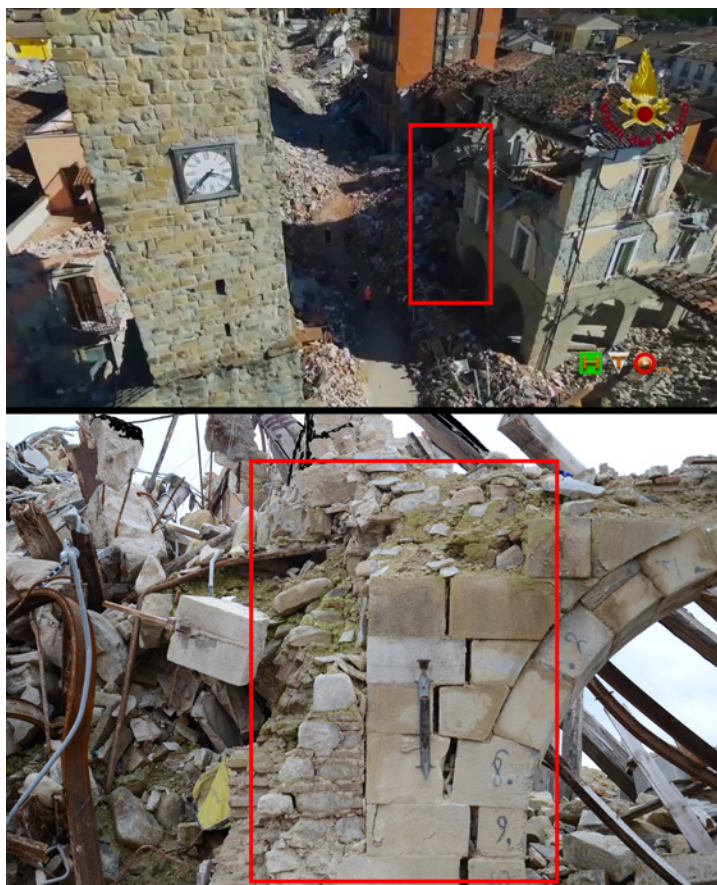
Fig. 3. Amatrice, foto aerea del palazzo Comunale nel 2016 e dettaglio della muratura.
