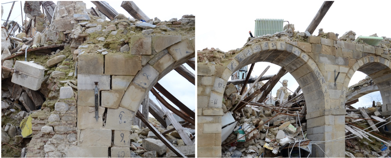
Fig. 3 Hôtel de Ville, détail des arches du sous-sol, Amatrice. A gauche, un détail de la continuité des murs du Corso Umberto I. A droite, le premier étage des arcs, avec des pierres de taille numérotées, vers Via Roma (photo de l'auteur).
