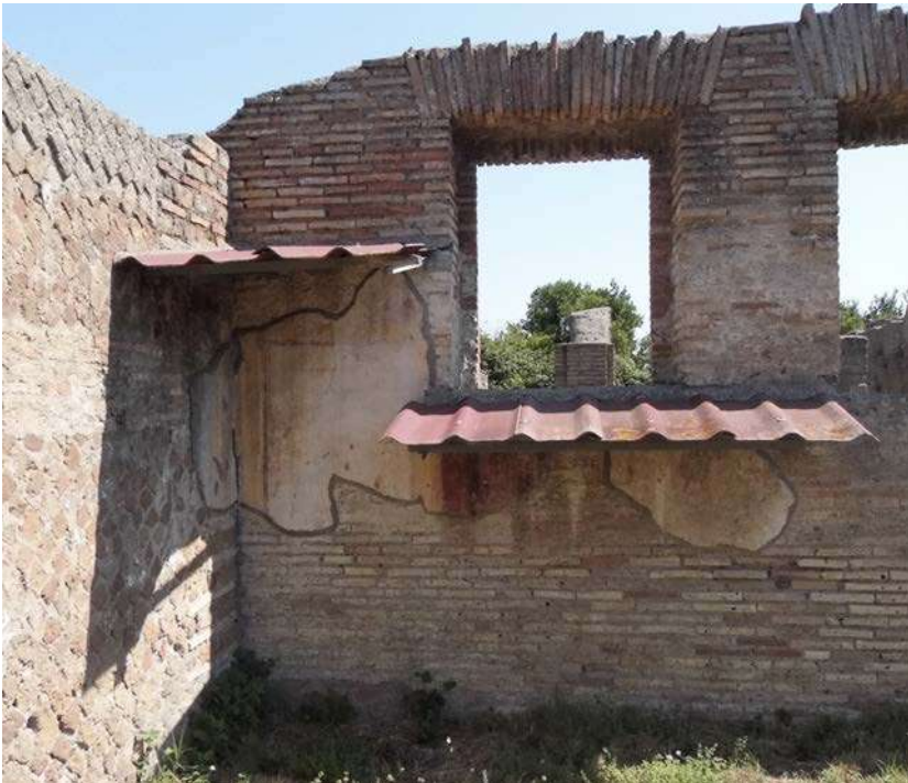
Fig. 3. Alterazione cromatica della tinta legata al soleggiamento e alla cattiva progettazione dei sistemi di protezione (foto dell'autrice).
