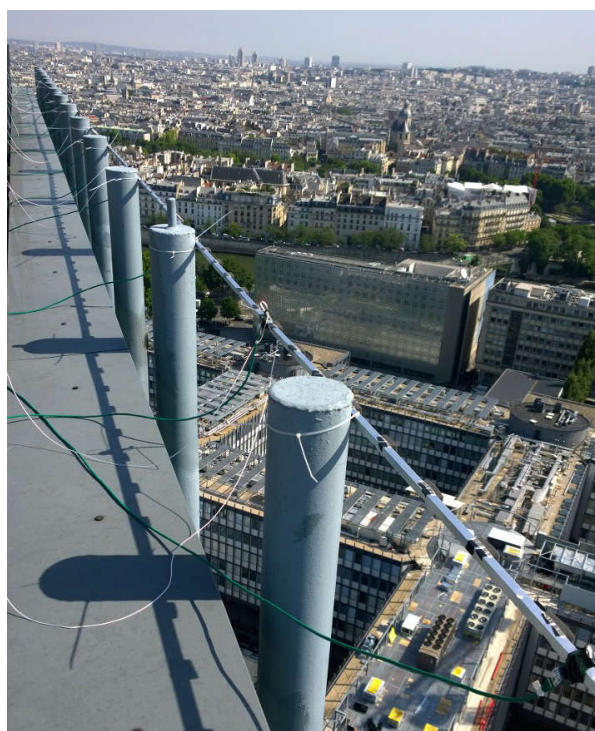
(b) Antenne accrochée sur support en haut de la tour Zamansky (90 m d’altitude).
