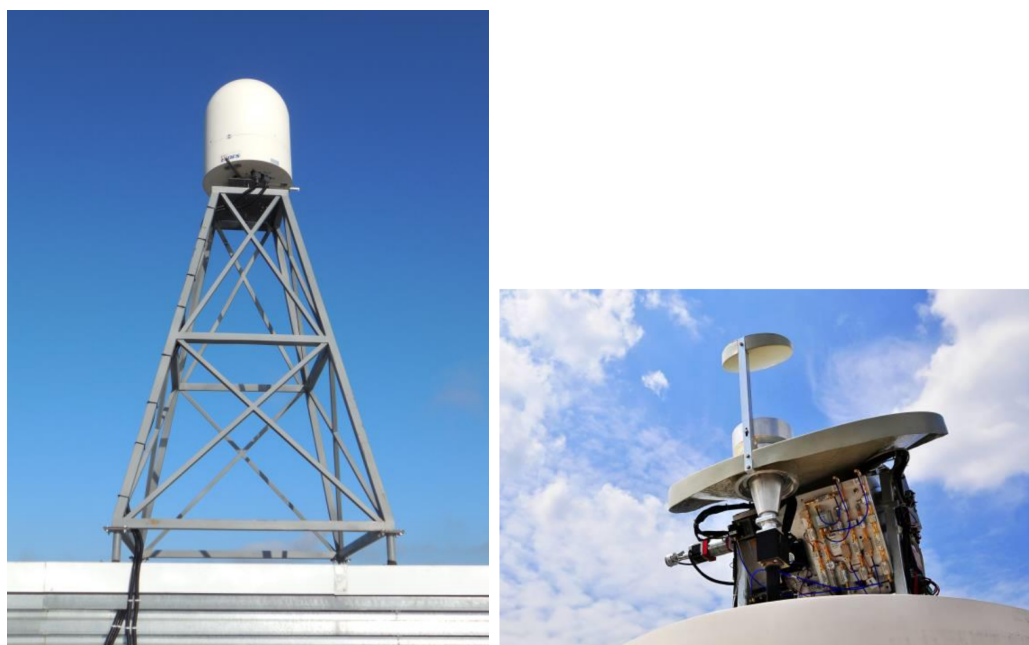
FIGURE 5.1 – Radar WR25XP en bande X. À gauche, un radar installé sur un toit de bâtiment et, à droite, le radar sans le radôme.
